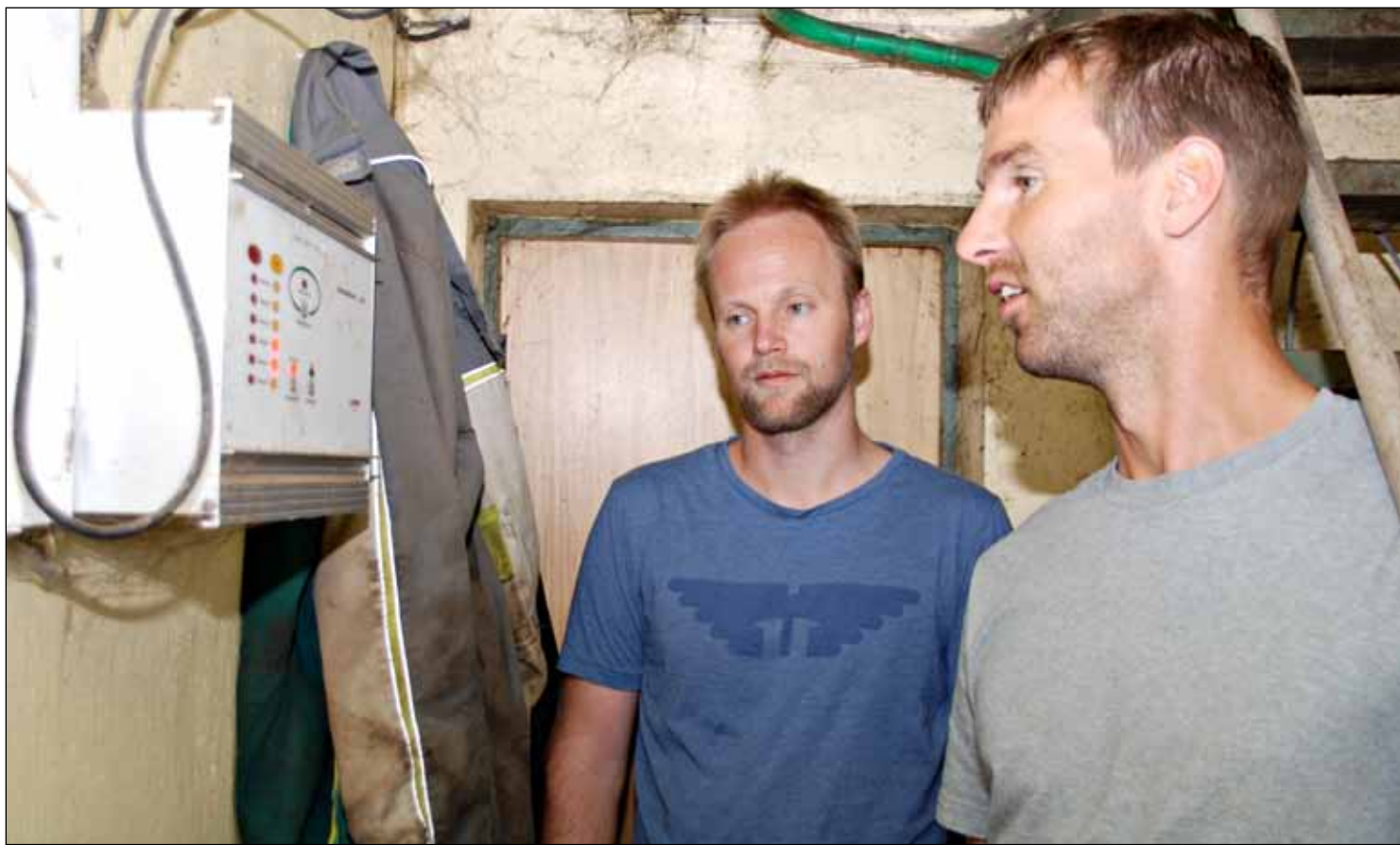
FUNGERER: Forskar ved HLB Olav Eggebø (t.v.) og bonde Leif Harbo frå Klepp i Rogaland konstaterer at Harbo sitt brannvarslingsanlegg no fungerer som det skal. Leif Harbo har to anlegg frå Elotec på garden. Det eldre anlegget har han meir eller mindre gitt opp å få til å fungere tilfredsstillande. Det nyaste anlegget fungerer no etter eitt år med intens prøving og feiling.
